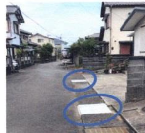
⑥コンクリート蓋 割れ対応
