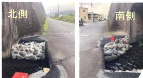
②堀の側壁 積石の崩れ対策(修復)
